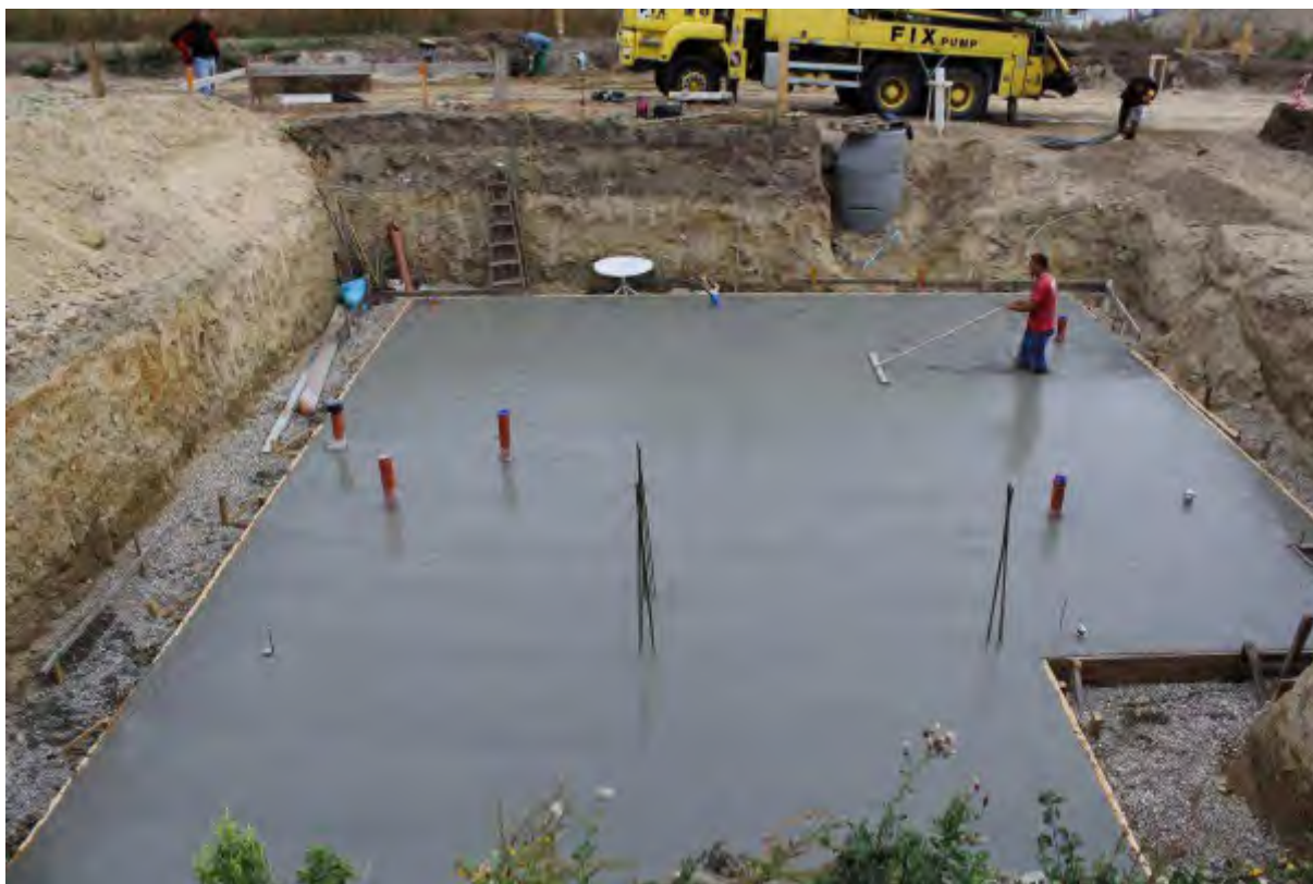
Abb. 32 Die im Zuge von Baumaßnahmen verursachten Bodenversiegelungen müssen durch Ersatz- oder Ausgleichsflächen egalisiert werden (Quelle: Website Hausbauinhaburg)
